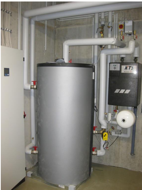
Abbildung 10: Technikzentrale Anbau – Warmwasserbereitung
