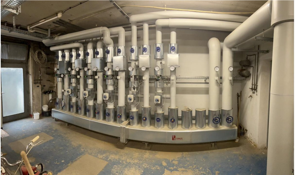
Abbildung 7: Heizverteiler in Heizzentrale Hauptgebäude Quelle: Eigene Abbildung
