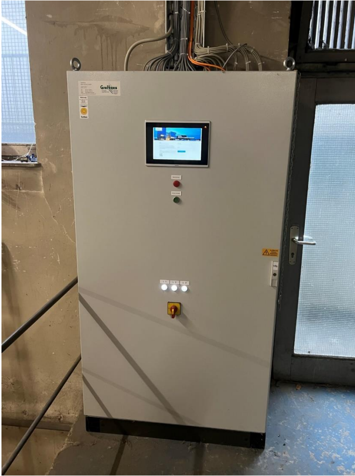
Abbildung 8: Schaltschrank Regelungstechnik Heizzentrale Hauptgebäude Quelle: Eigene Abbildung
