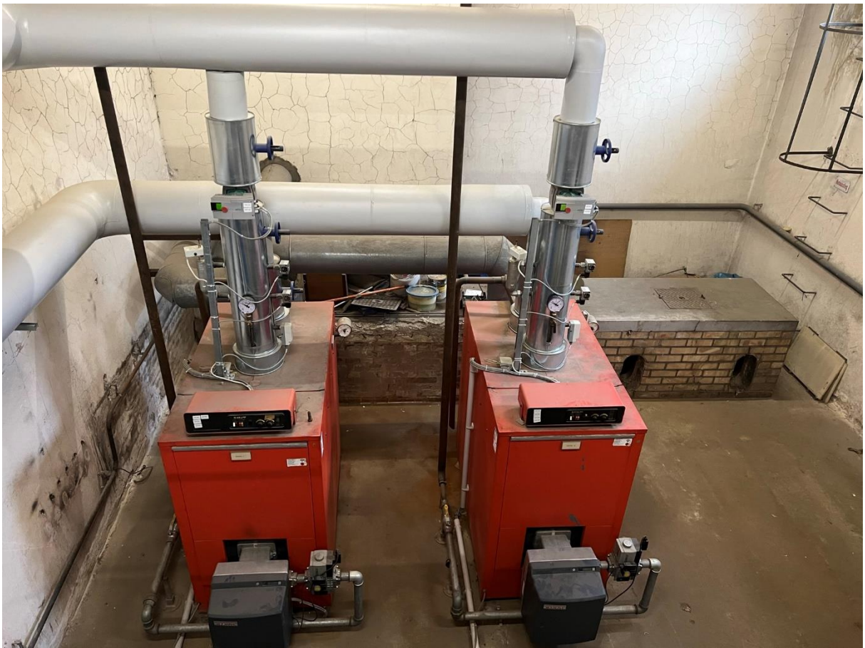
Abbildung 6: Heizzentrale Hauptgebäude Quelle: Eigene Abbildung
