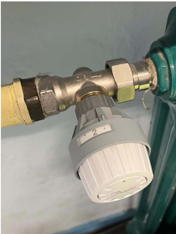
Abbildung 5: Installierte Heizkörperthermostate Quelle: Eigene Abbildung
