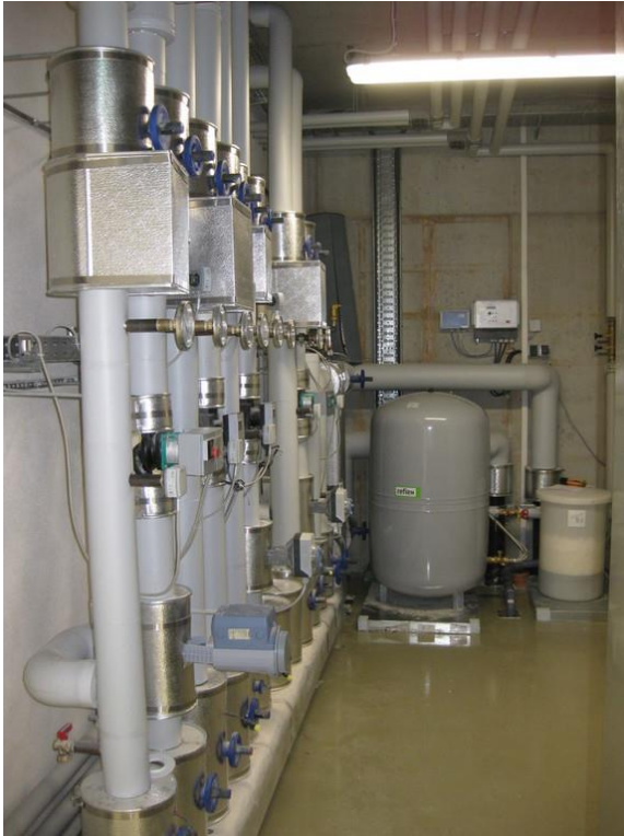
Abbildung 9: Technikzentrale Anbau – Heizverteiler
