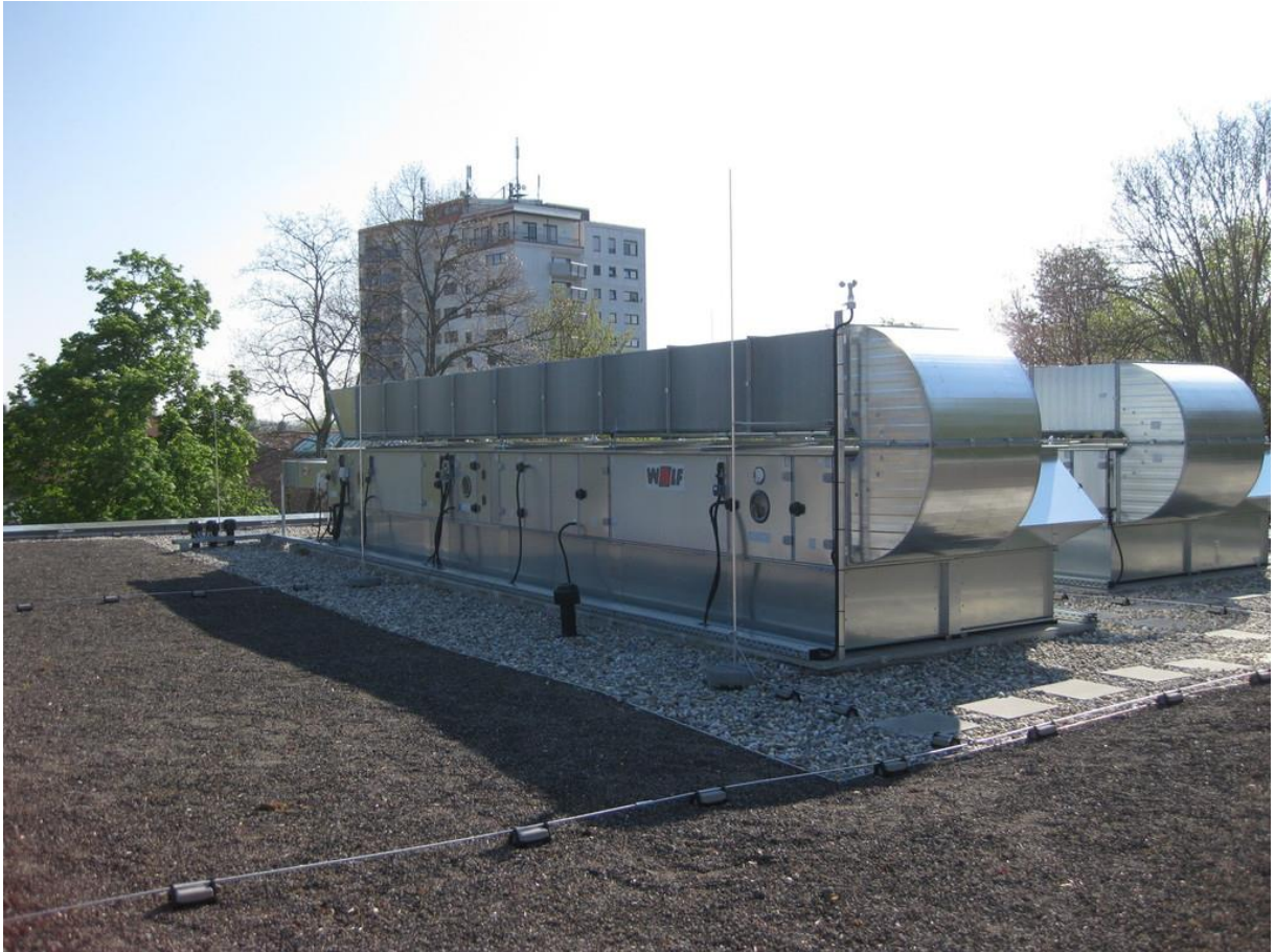
Abbildung 11: Lüftungsgeräte Dachbereich Anbau
