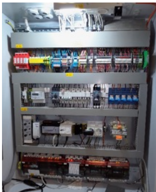
Schaltschrank vor dem Umbau
