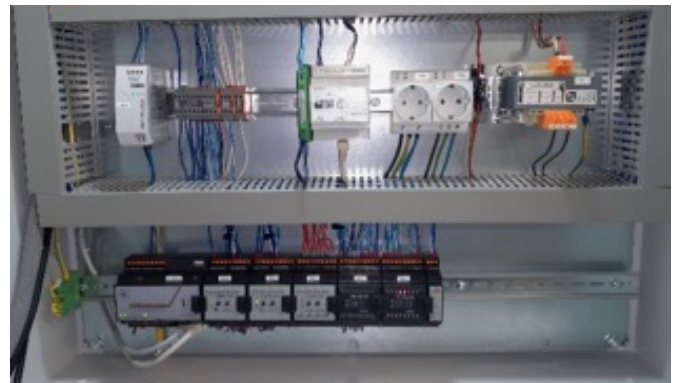
Schaltschrank nach dem Umbau – mit der platzsparenden DEOS Hardware inkl. DI16/G IO-Modul und BACnet DDC-Controller
